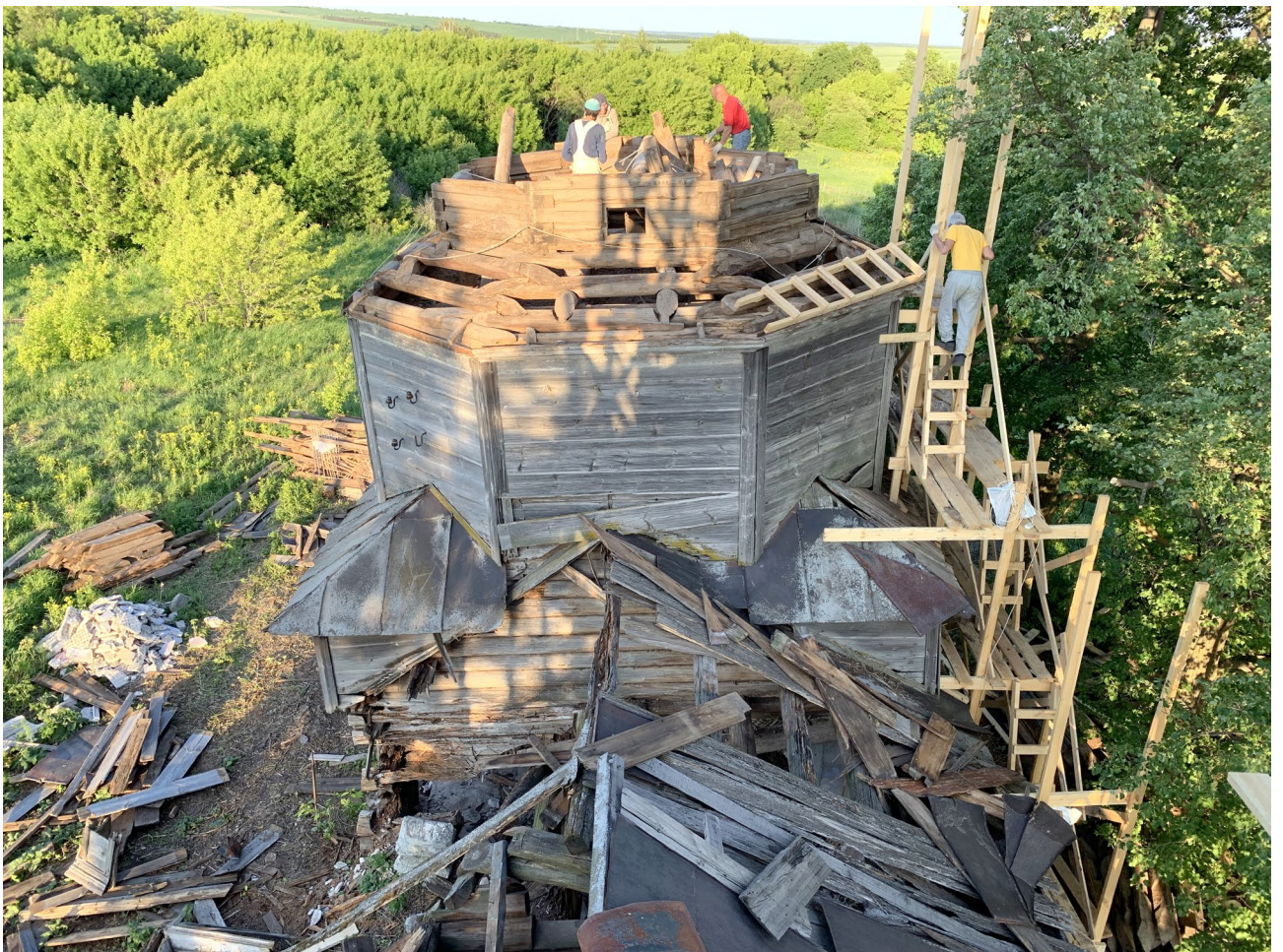
Илл. 30. Разборка сруба второго восьмерика. Вид с запада. На западной стене второго восьмерика продух.
