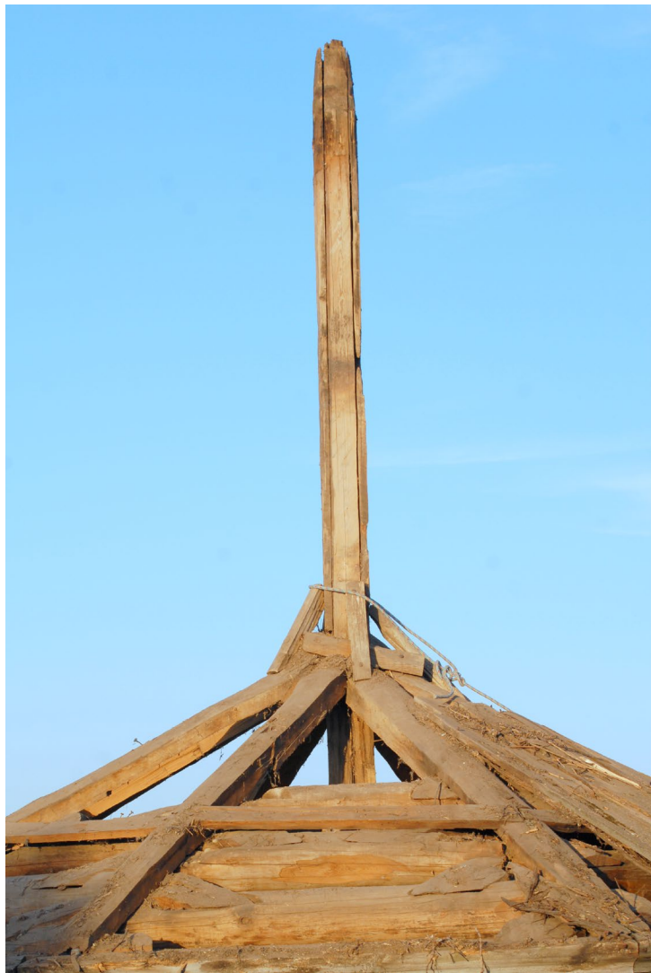
Илл. 33. Подкрестный столб усиленный (изначально) досками. Стропильная конструкция второго восьмерика.
