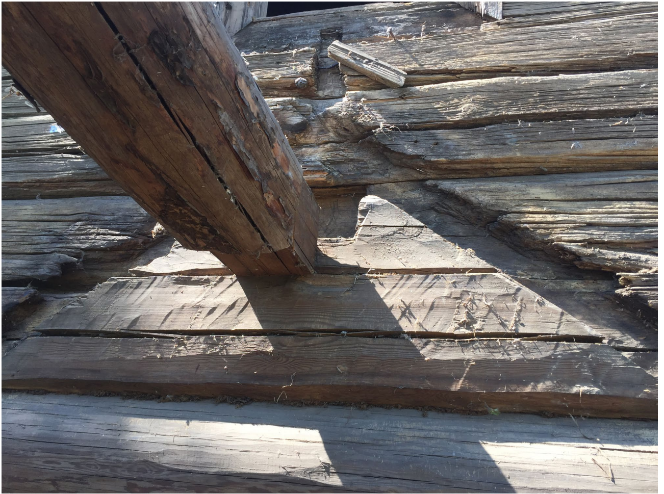
Илл. 139. Следы конструкции кровли алтаря XVIII в. - гнездо коньковой слепи, штроба под тес и след от гребня (осталась набивка для фиксации гребня в вертикальном положении).
