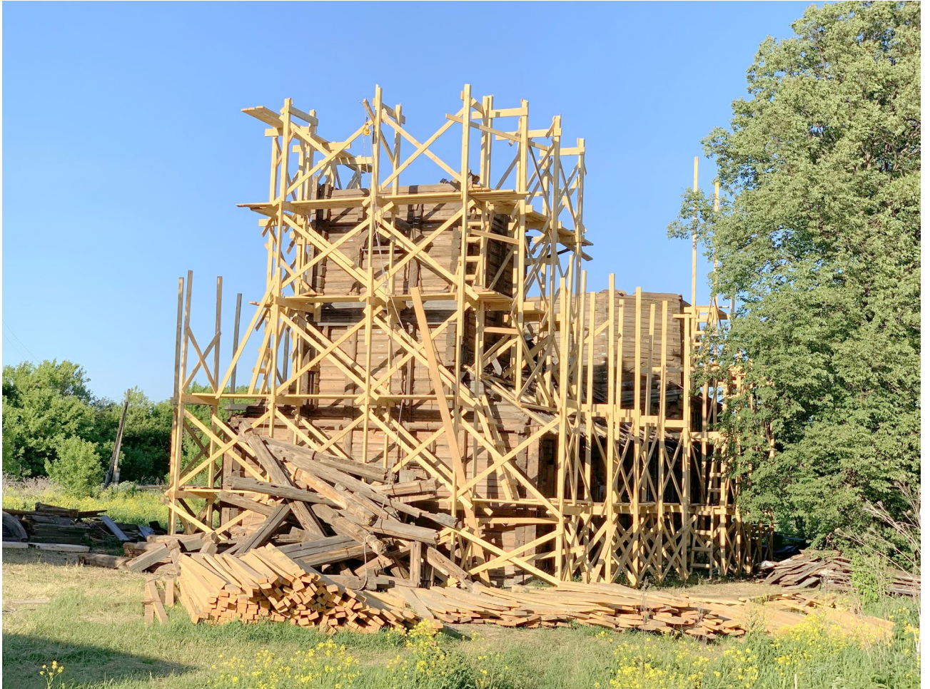
Илл. 81. Разборка конструкций колокольни на стадии балок пола яруса звона. Вид с юго-запада.
